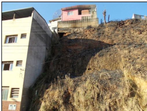
Ponto 24. (Talude com declividade excessivo).
