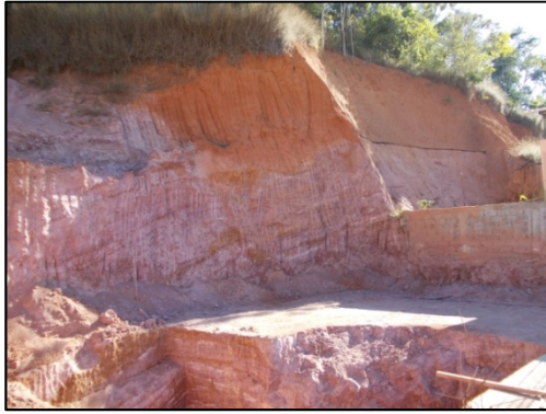
Ponto 29 (Talude com corte e declividade excessiva e solo residual jovem exposto).
