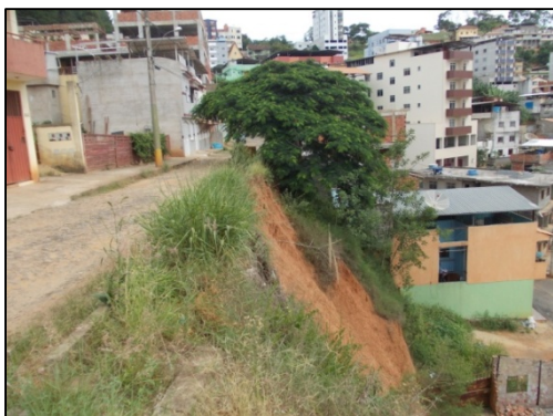
Ponto 83 (Talude de corte com altura e declividade excessiva com drenagem no topo deficiente).
