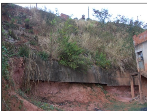
Ponto 18 (Descalçamento de muro de contenção)
