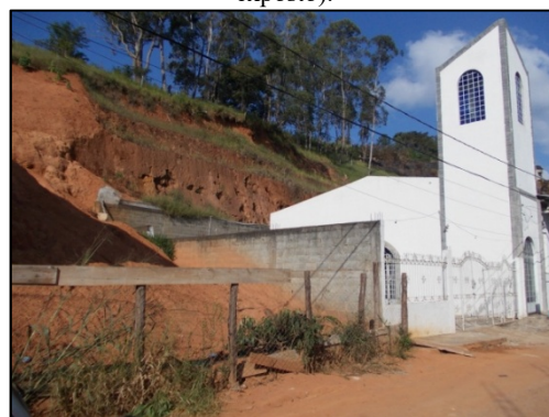
Ponto 96 (Talude com drenagem danificada iniciando processos erosivos).
