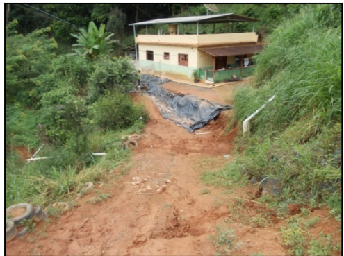
Ponto 92 (Degrau de abatimento nas margens do ribeirão)
