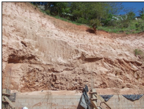
Ponto 75. (Corte de talude com declividade acima do limite de segurança.)
