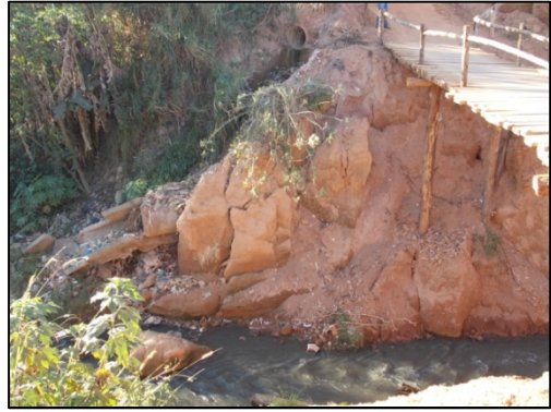
Ponto 30 (Destruição da galeria por processo de solapamento).
