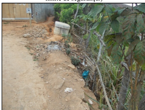
Ponto 17 (Lançamento de lixo e entulho no topo do talude).
