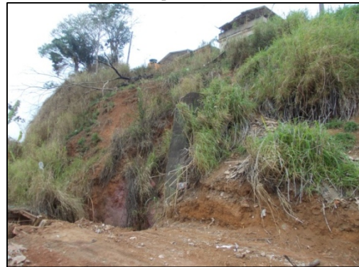
Foto 20: Ponto 32 (Escada hidráulica destruída e voçoroca na base do talude).
