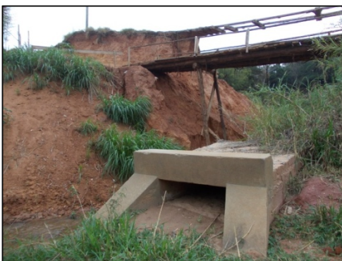
Ponto 33 (Galeria destruída solapamento de margens)
