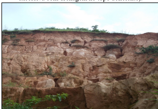
Ponto 84 (Talude em solo residual jovem com processo erosivo avançado).
