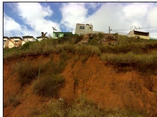
Ponto 101 (lançamento de entulho no topo do talude).
