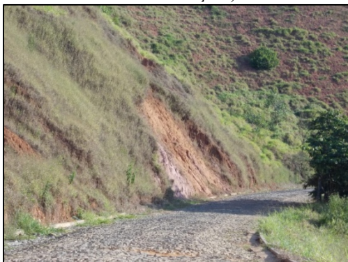
Ponto 96 (talude com declividade superior a 45% e drenagem danificada).
