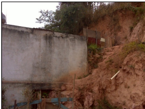
Ponto 100 (talude com declividade excessiva sem muro de contenção).
