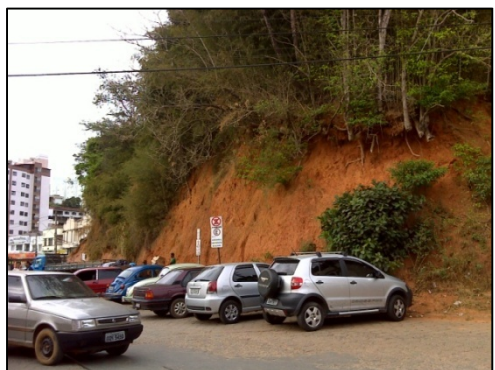
Ponto 99 (Talude com declividade excessiva).
