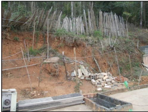
Ponto 43 (Talude com drenagem natural danificada e drenagem artificial inexistente).
