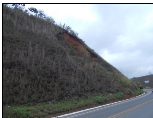
Ponto 11 (talude com drenagem natural danificada com ocorrência de escorregamento).
