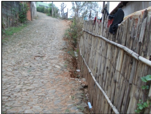
Foto 19: Ponto 31 (Drenagem da rua danificada).
