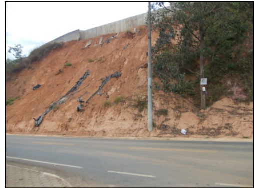
Ponto 44 (Talude de corte com altura e declividade excessiva, com drenagem artificial no topo inexistente com ocorrência de escorregamento).
