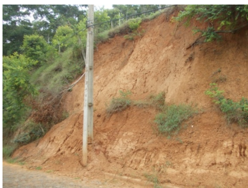
Ponto 82 (Talude de corte com altura e declividade excessiva e drenagem natural danificada).
