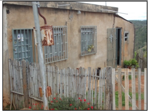
Ponto 49 (Trincas na moradia construída sobre aterro).
